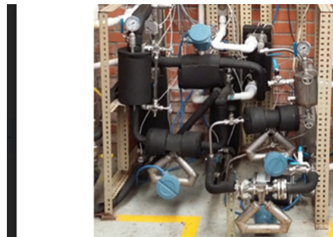
Figura 1.. Sistema de refrigeración por absorción con intercambiadores de placas
