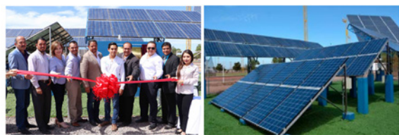
Figura 2. Parque Solar Fotovoltaico instalado en ITSON.
